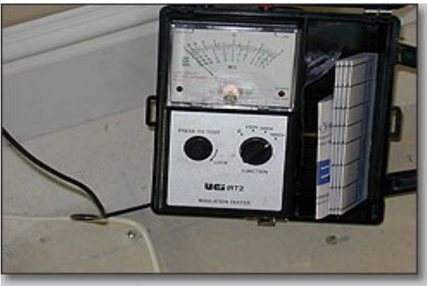
Megger Test przewodu grzejnego
