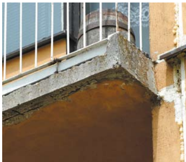
Odspojenie betonu na obrzeżach balkonu.
