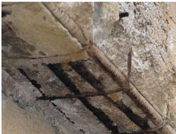
Odspojenie betonu od skorodowanego zbrojenia.
