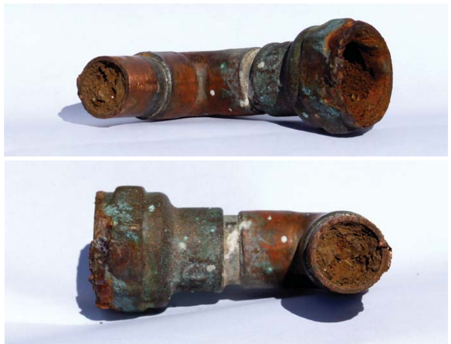
Rys. 11. Skutki zaniedbań w zakresie uzdatniania wody
