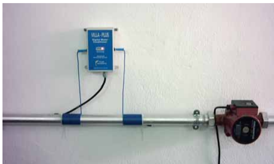
Rys. 5. Montaż elektromagnetyzera polega na zamocowaniu części komputerowej w okolicy rury i nawiązaniu przewodów (anten) na rurę zasilającą za wodomierzem
